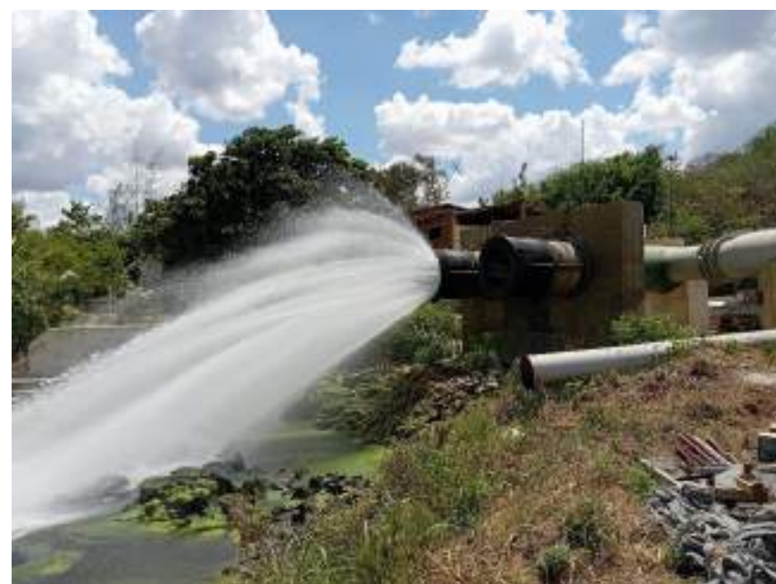
Visita a válvula dispersora do açude de Boqueirão (PB) com vazão de saída de 240 L/s
